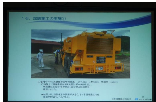
“舗装工事（路面切削）における建設ICTの活用事例” モデル工事を受注して初めて分かるICT施工の特性を実際に施工した技術者の生の声から学びました。
