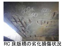
RC床版橋の劣化損傷状況
