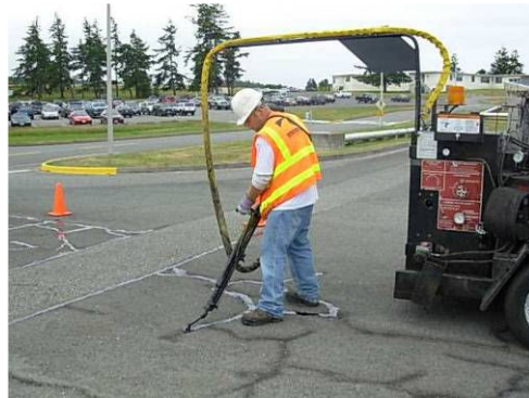
米国におけるクラック補修の例
