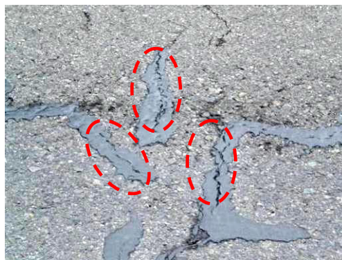
ブローンアスファルトのひび割れの例
