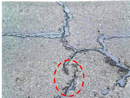
ブローンアスファルトの剥離の例
