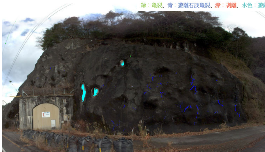
図7. 全周囲画像解析 損傷抽出例
