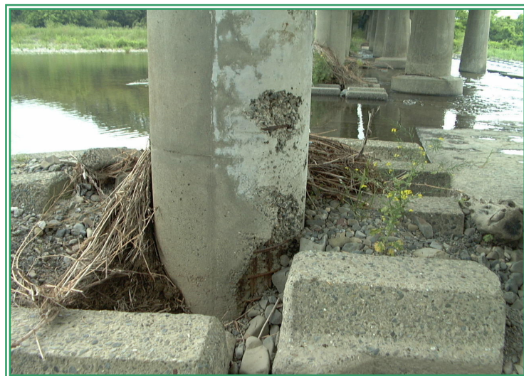
写真-4 凍結融解による損傷
