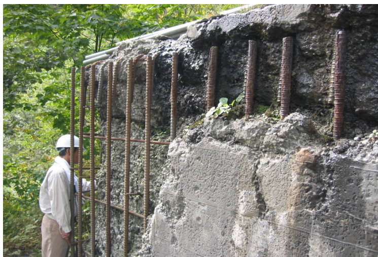
写真-6 複合劣化の事例(フーチング)
