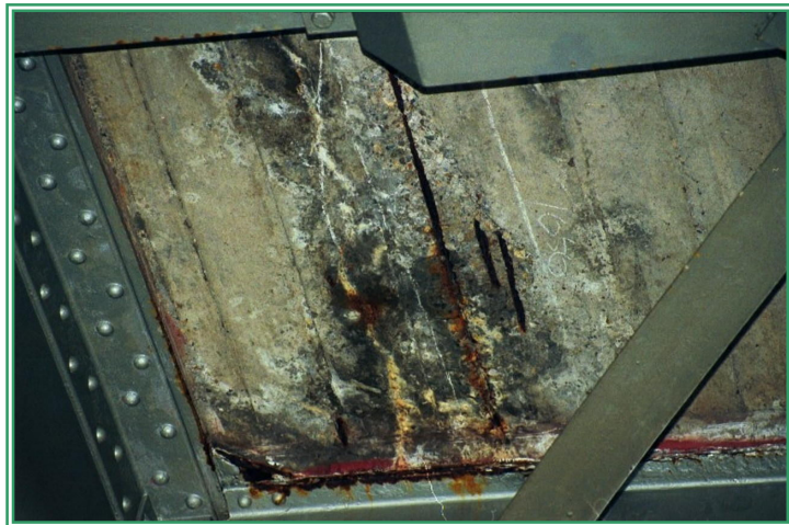
写真-3 塩害による鉄筋腐食
