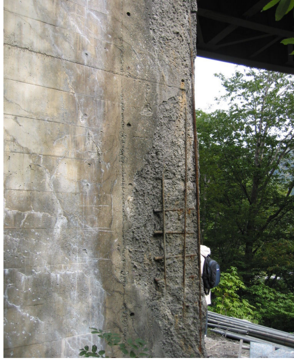
写真-5 複合劣化の事例(堅壁)
