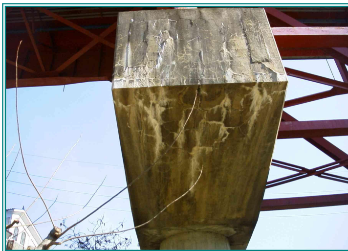
写真-1 アルカリ骨材反応による損傷
