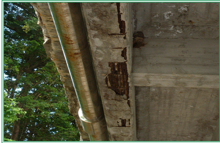
写真-2 塩害による鉄筋腐食
