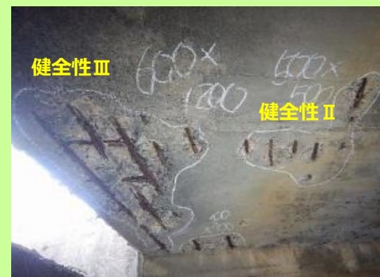
RC床版橋の劣化損傷状況
